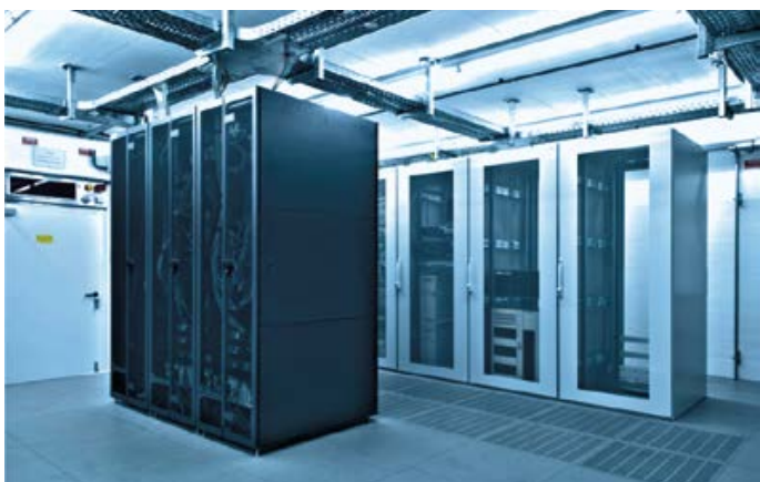
Серверные и уличные шкафы
