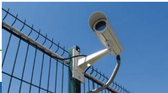
Решения для прокладки слаботочных кабельных трасс и систем безопасности
