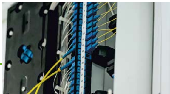
Организация сетей в подвале или щитовой
