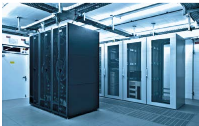
Серверные и уличные шкафы
