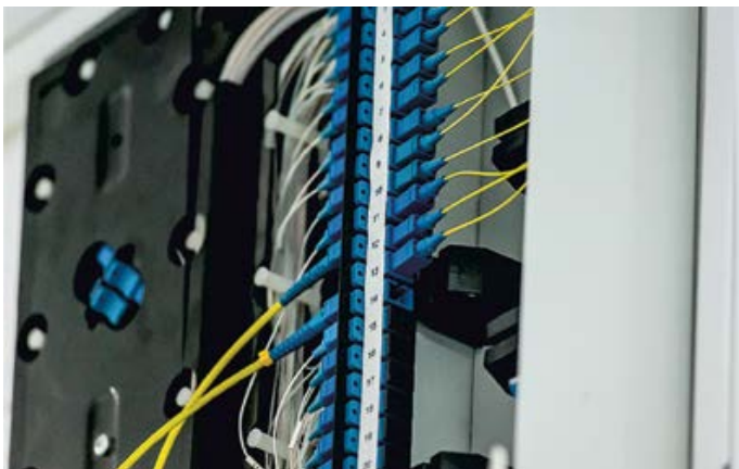
Организация сетей в подвале или щитовой
