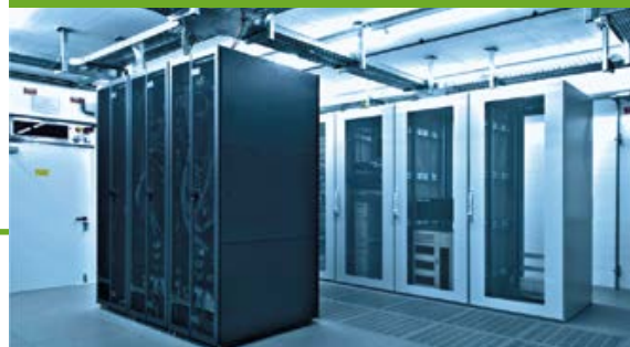
Серверные и уличные шкафы
