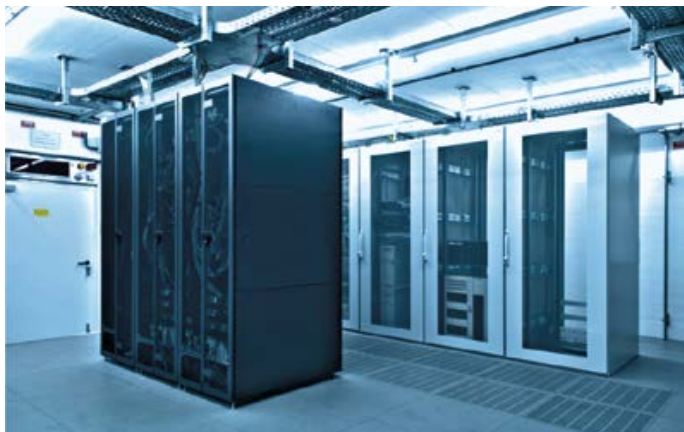
Серверные и уличные шкафы с системой мониторинга
