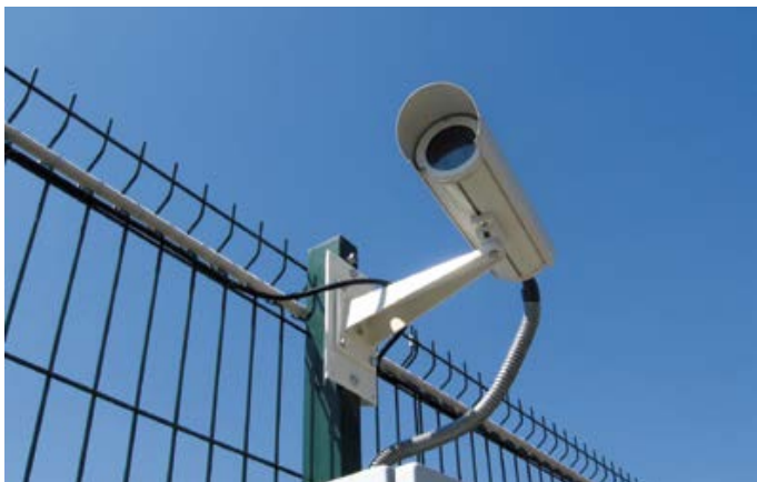
Решения для прокладки слаботочных кабельных трасс и систем безопасности
