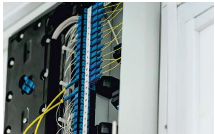
Организация сетей в подвале или щитовой
