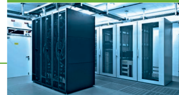
Серверные и уличные шкафы
