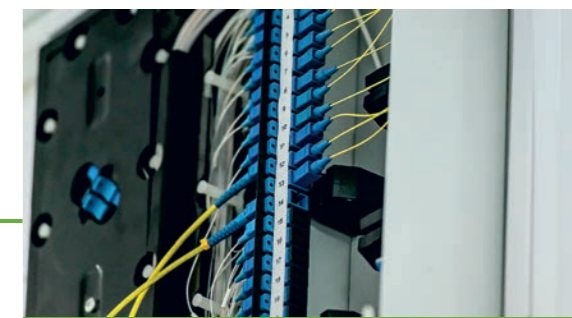
Организация сетей в подвале или щитовой
